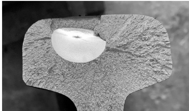
Рис.1. Внутренняя поперечная трещина в головке рельса
