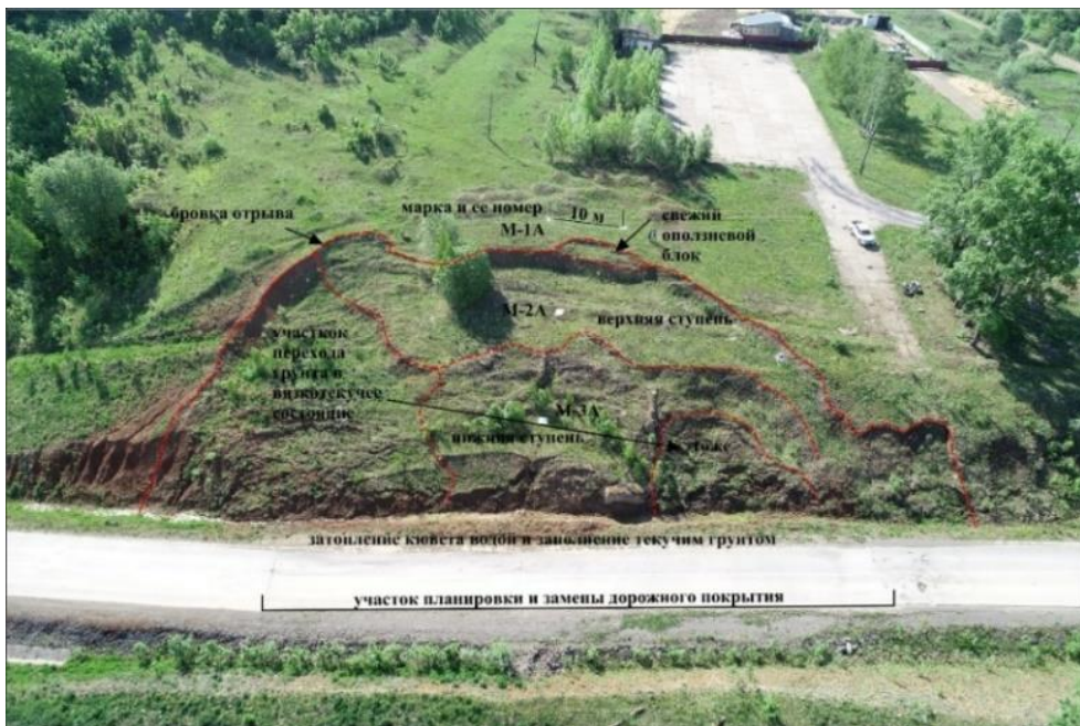
Рисунок 4 - Оползень по автодороге на горнолыжный комплекс Аджигардак (ТН 1), связанный с дорожным строительством на Ашинский участок в Челябинской области (снимок БВС)
