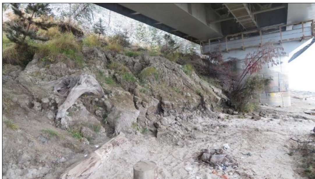
Рисунок 7 - Активизация оползневой процесса в г. Ханты-Мансийске, на участке Восточной объездной автодороги
