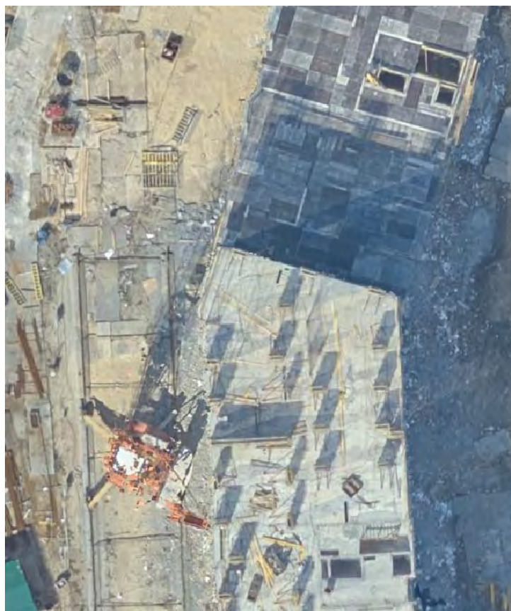
Рисунок 8 – Изображение строящегося здания на истинном ОФП, построенном автоматически. Углы строения опознать проблематично.
